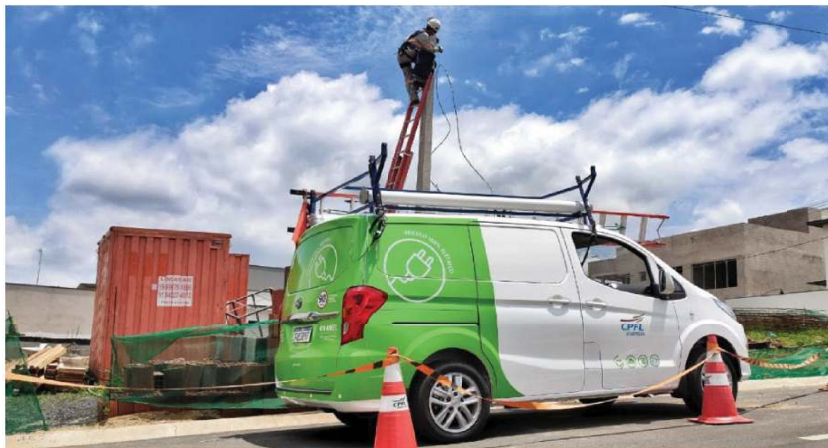
Figura 33. Imagem do veículo emergencial elétrico da CPFL Indaiatuba
