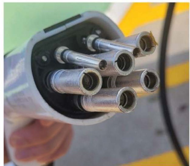
Figura 25. Imagem de conector danificado
