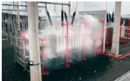
Sistema de combate a incêndio em transformadores de 230 kV.
