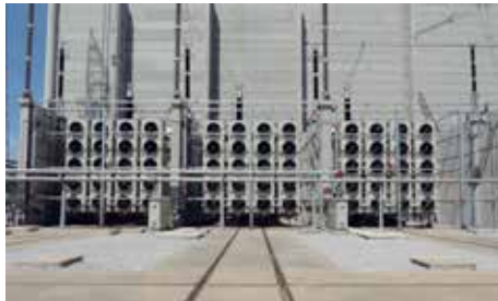
Subestação de 800 kV, 4.000 MW e 12 transformadores.
