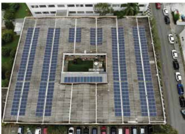
Figura 4 – Vista aérea da usina FV-DELT.
